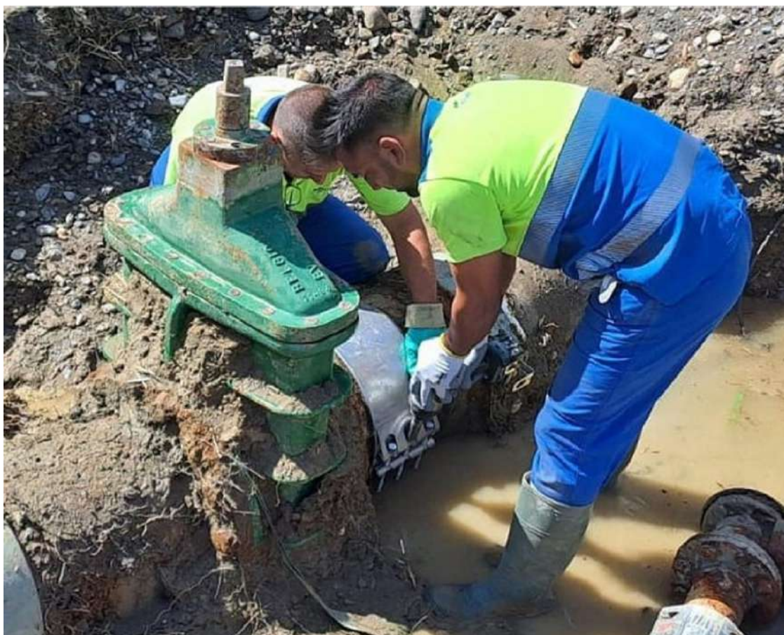
Aqualia espera restablecer el suministro en Cártama lo antes posible.
